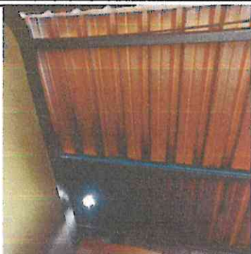
Foto 1: Lámina troquelada en mal estado
