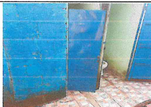
Foto 4: Puertas de sanitarios en mal estado, falta de repello y cernido
