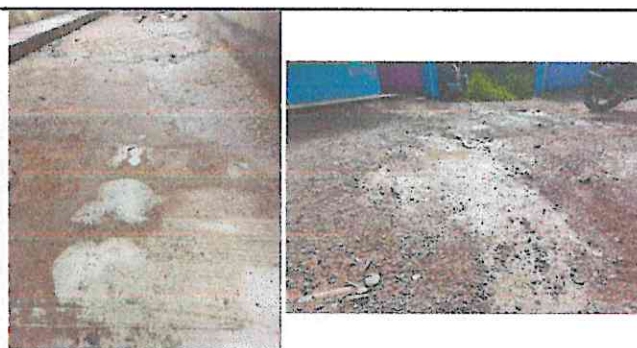
Foto 6: Losa de patio en mal estado
