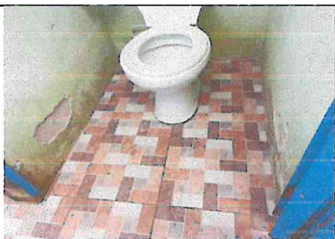
Foto 5: Taza sanitaria y paredes con repello deterioradas
